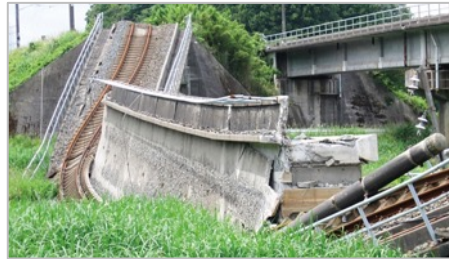
JR常磐線の橋梁が倒壊
